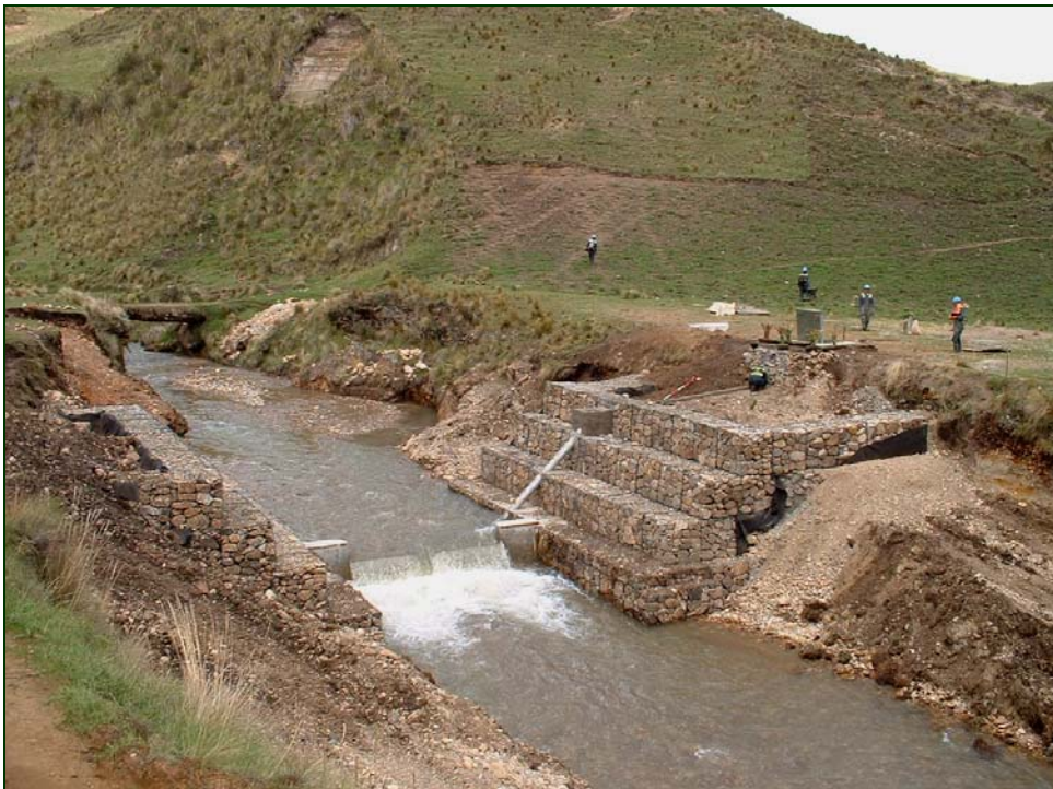
Foto 3-8 Vertedero con el Área de Control de Gaviones
