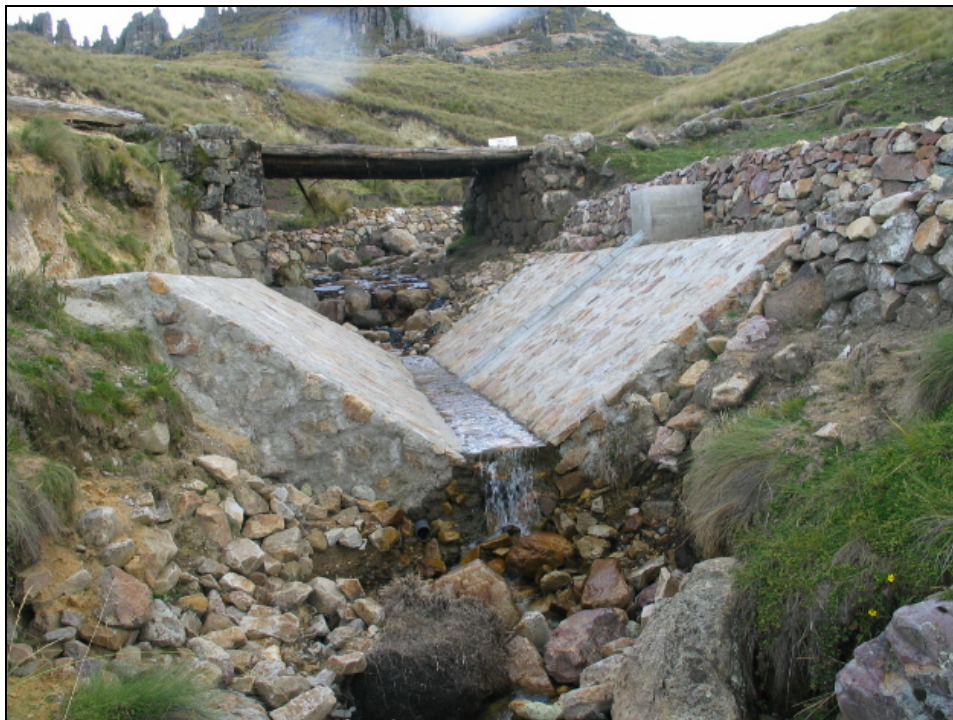
Foto 3-10 Sección Trapezoidal de Control para Medición de Flujo
