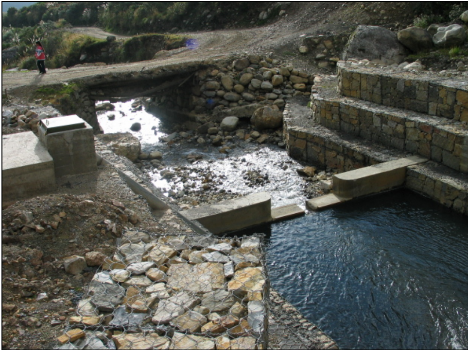
Foto 3-7 Vertedero con el Área de Control de Gaviones
