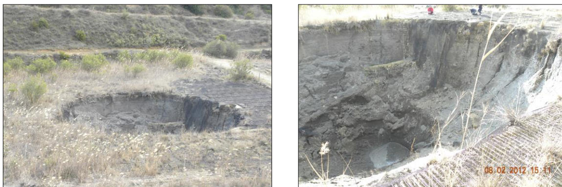
Figura 73. Hundimiento del vaso de una presa de lodos en La Carolina (Jaén) asociado al arrastre del material a través del sistema de drenaje de fondo.
