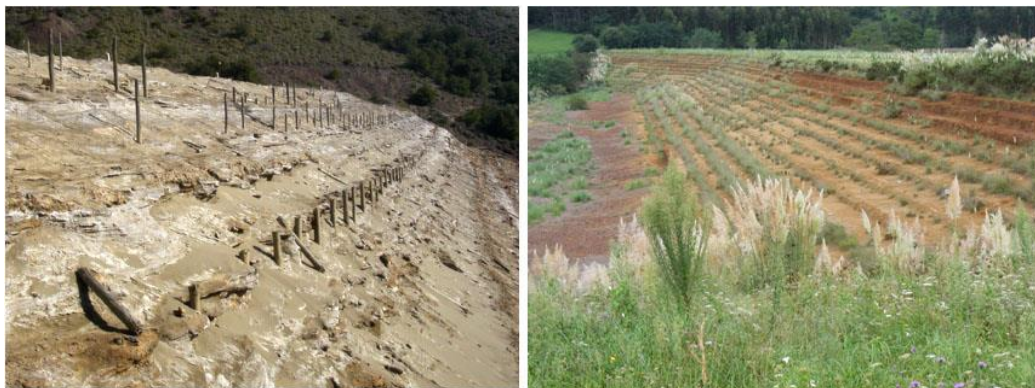
Figura 65. Construcción del dique de una presa de lodos por el método arcaico. Se observan los restos de los palos usados en el recrecimiento. A la izquierda la presa de lodos conocida como Lirio (Sierra Minera de Cartagena-La Unión, Murcia), y a la derecha la presa La Garma (Cartes, Cantabria).
