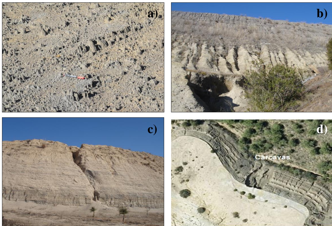
Figura 74. Formas de erosión hídrica en diques de presas de lodos: a) erosión por salpicadura; b) erosión en regueros y tubificación al pie del dique; c) acarcavamiento; d) erosión en regueros y cárcavas.
