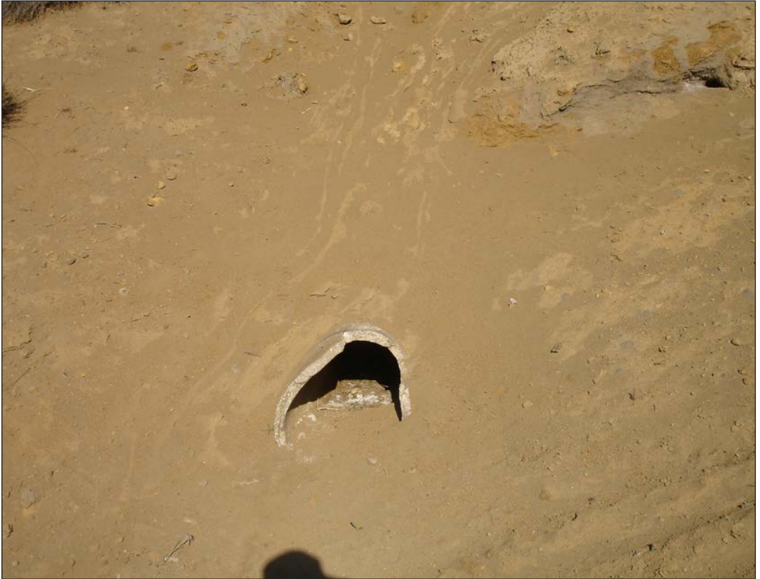
Fotografía 18. Tubería de drenaje de la presa roto y colmatado de lodos
