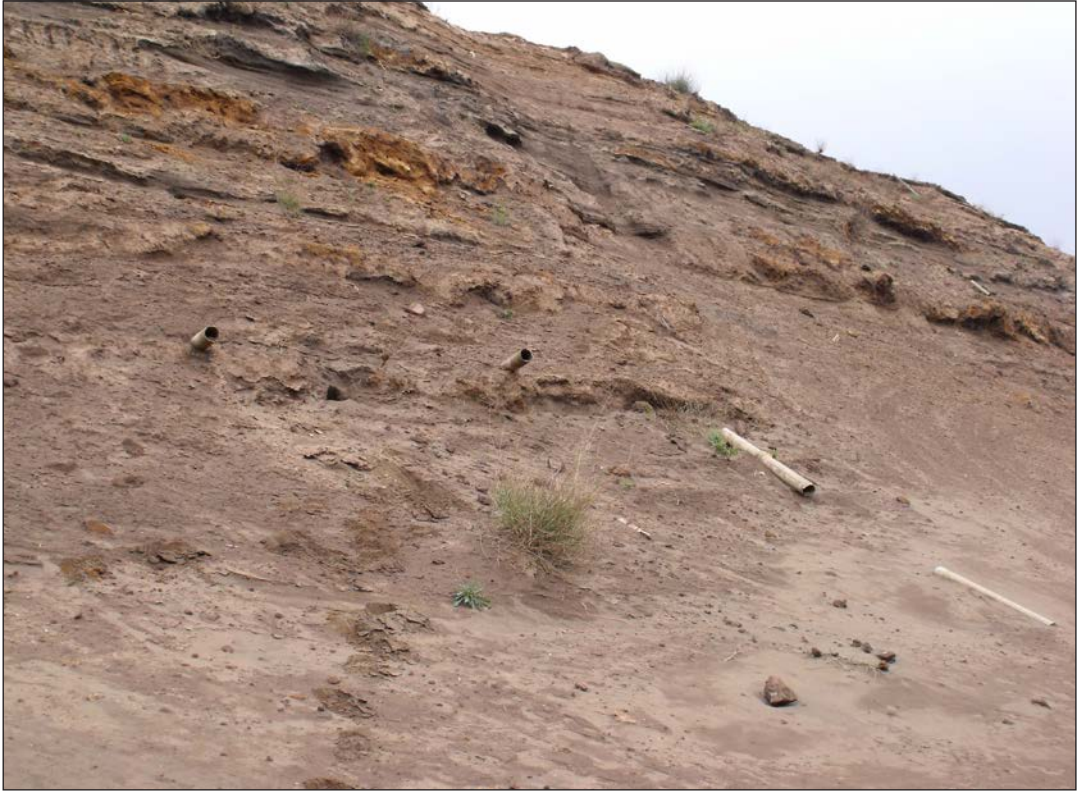
Fotografía 20. Dique con drenes californianos no funcionales para drenar el talud
