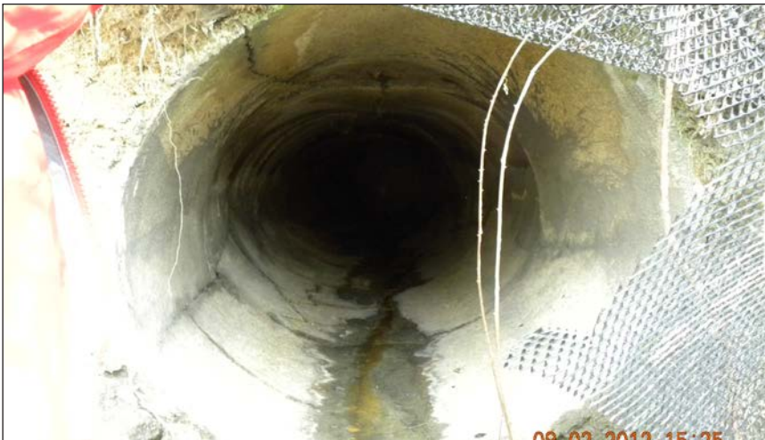
Fotografía 30. La tubería de drenaje del fondo de la presa anterior se encuentra deformada, por lo que el hundimiento puede estar relacionado con el fallo de este sistema de drenaje
