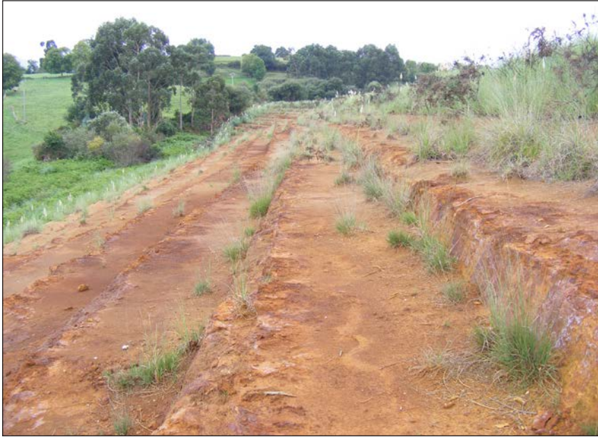
Fotografía 24. Formaciones de costras de hidróxidos de hierro en el talud
