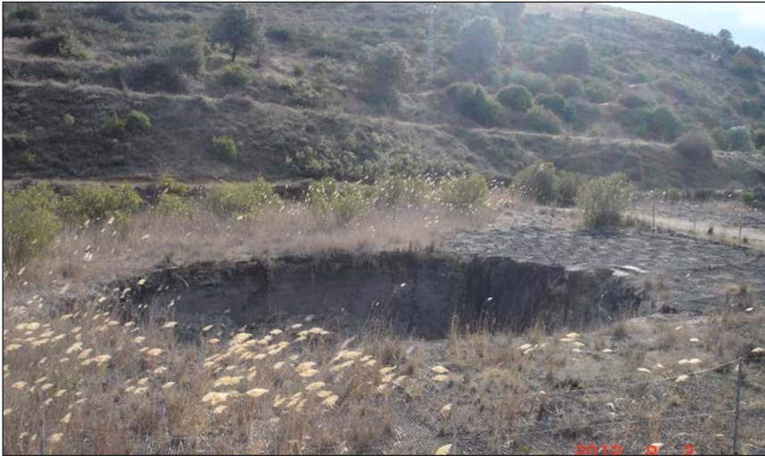
Fotografía 29. Hundimiento del vaso de una presa restaurada con geotextil y gramíneas próxima al arroyo de la Campana en La Carolina
