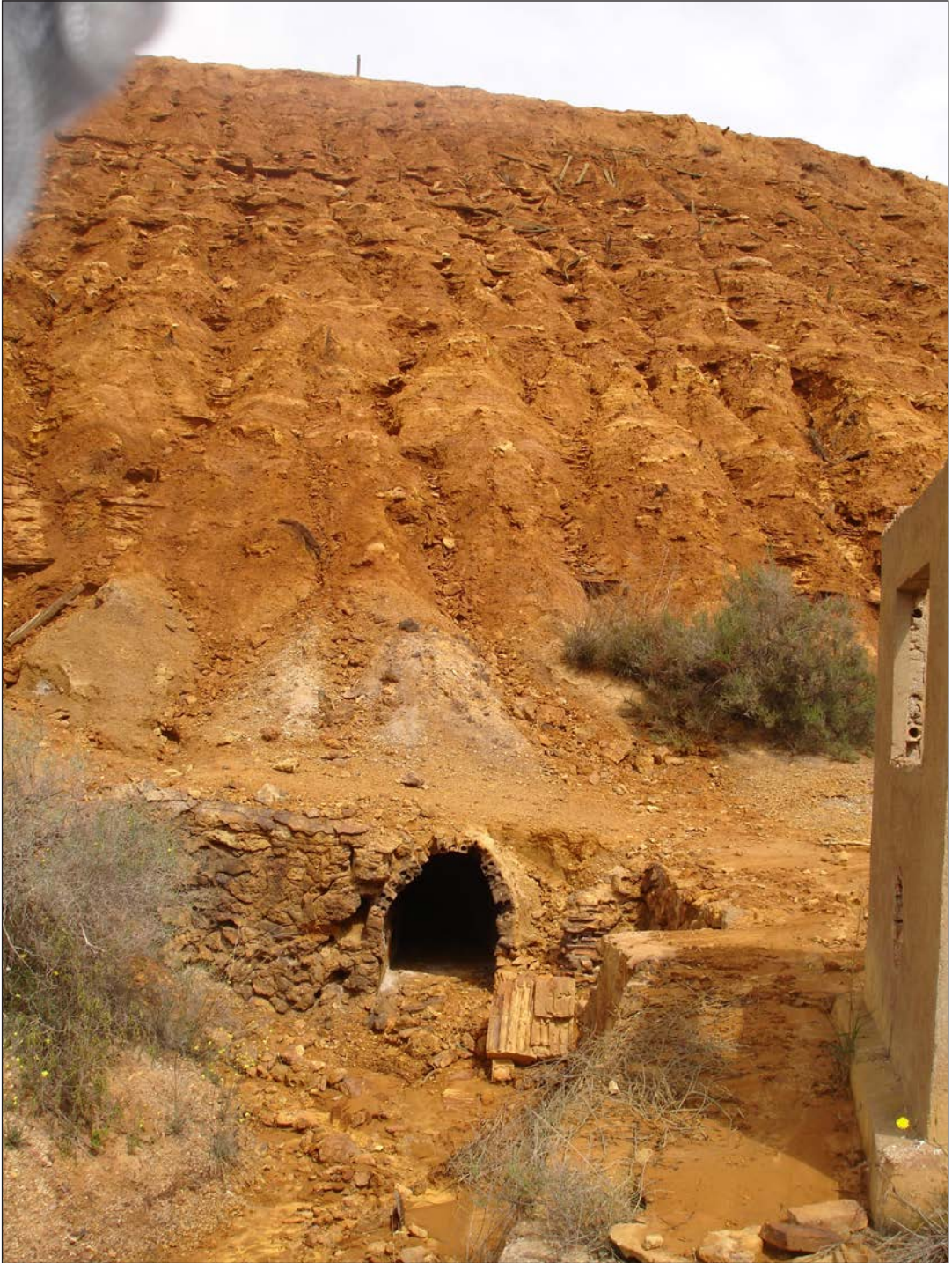
Fotografía 19. Galería de drenaje de fondo no funcional con presencia de sales
