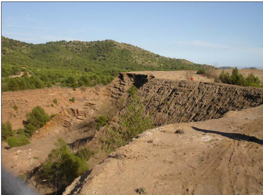
Fotografía 12. Deslizamiento profundo en dique, posiblemente por tubificación o piping consecuencia del colapso de la chimenea
