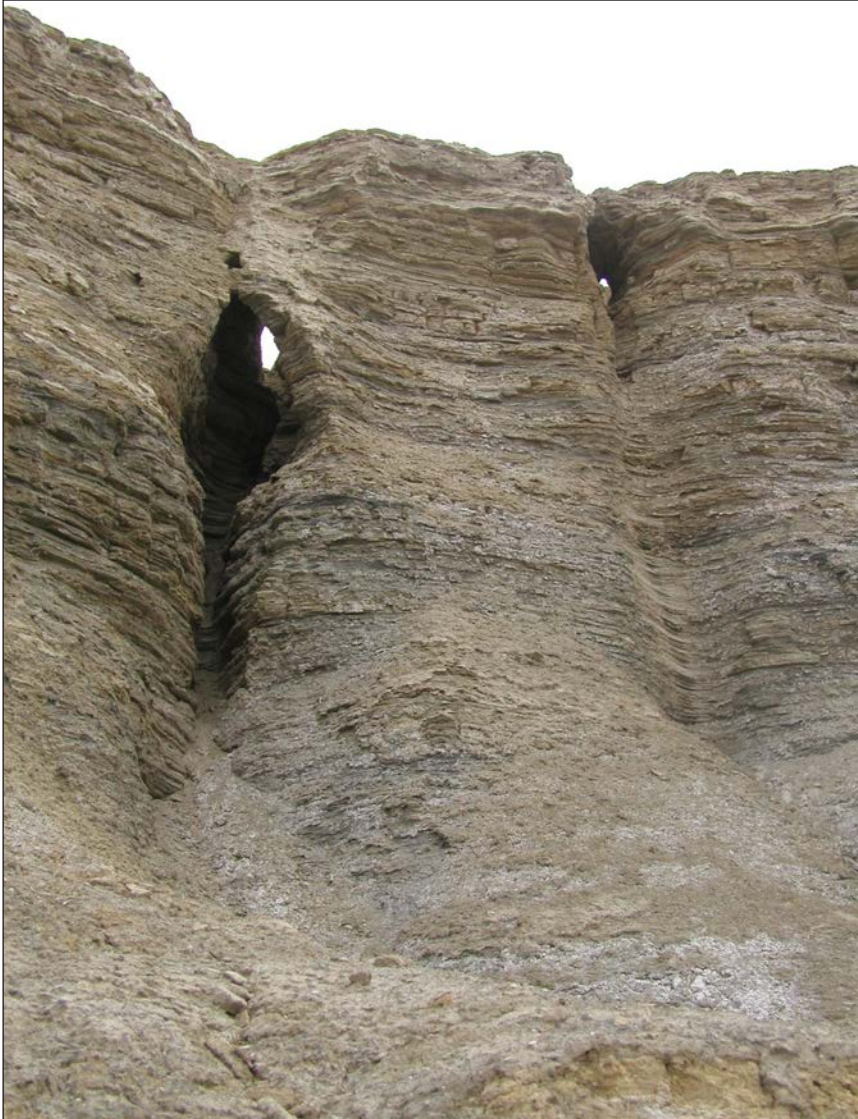
Fotografía 13. Tubificación en dique
