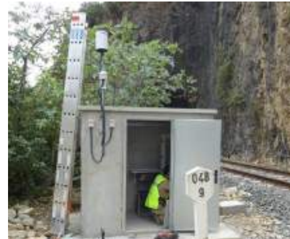
Red de auscultación geotécnica (1.471 puntos de control)
