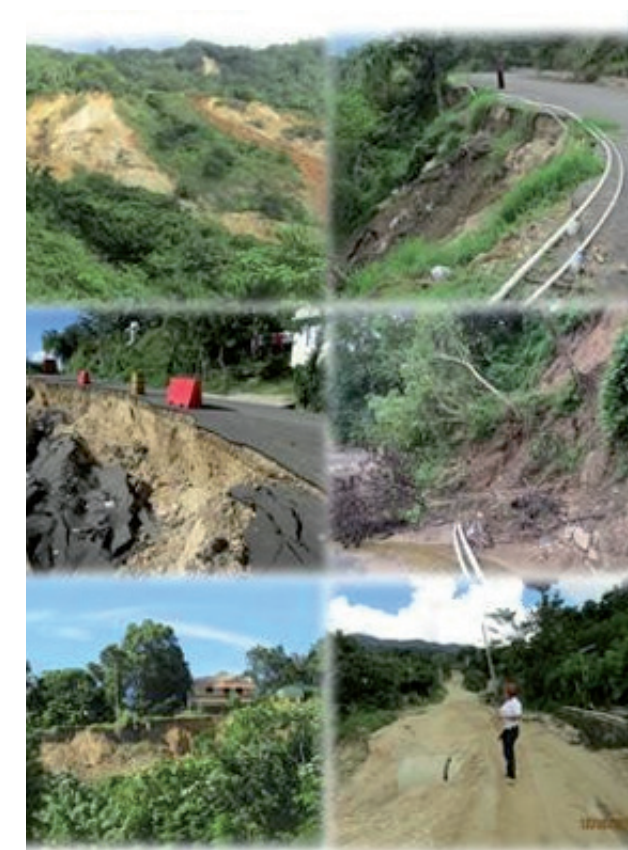
Figura 2. Vistas del deslizamiento en los viales en la zona de estudio.
