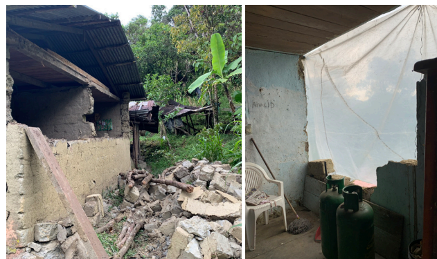
Figura 7. Daños observados en las viviendas del área rural de San Juanito, Meta: separación de muros y colapso parcial (foto izquierda) y total (foto derecha) de un muro de adobe.
