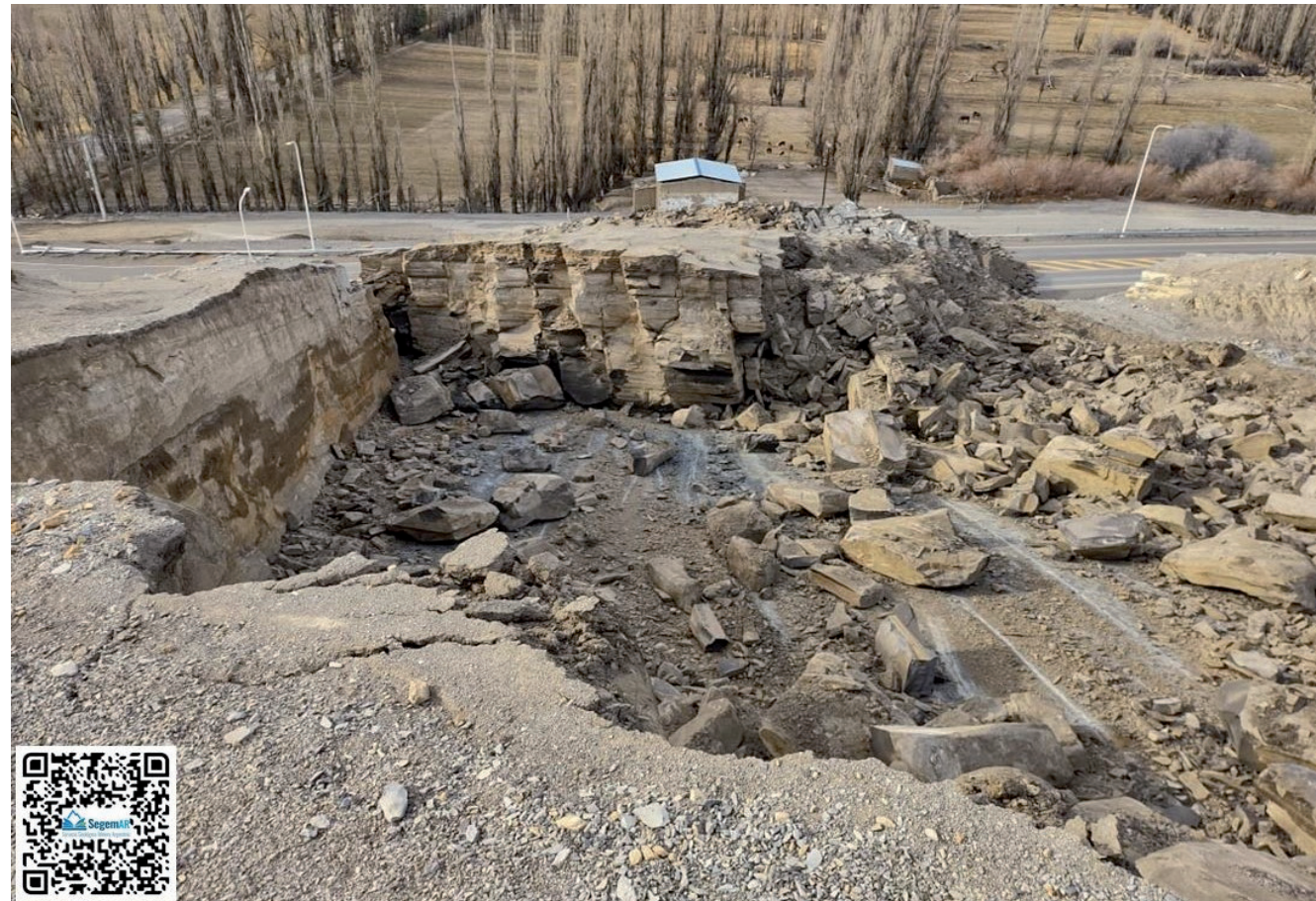
Figura 1. Deslizamiento planar ocurrido el 1° de agosto de 2023 en el cerro de la Virgen, ruta provincial 43, Chos Malal. En la fotografía, tomada dos días después del evento, se puede apreciar la superficie plana y estriada, sobre la cual se produjo el deslizamiento, correspondiente a un plano de estratificación. El código QR lleva al informe original del evento.
